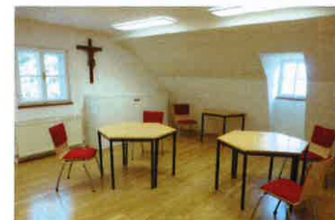
Im Zuge des neuen Konzepts für das Kloster Salzburg (siehe S.20) wurden Umbau- bzw. Renovierungsarbeiten wie hier für den Seminarraum vorgenommen.
